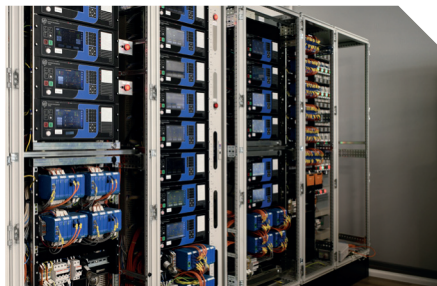
Участок сборки шкафов управления и автоматики
