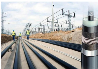
Силовые кабельные линии >110 кВ
