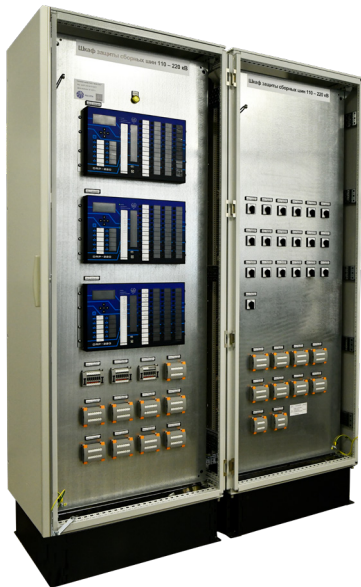
Релейная защита и автоматика 110-220 кВ
